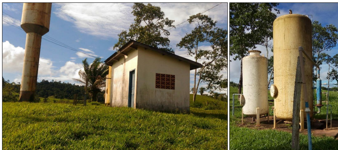
Figura 100 - Área da Estação de Tratamento do Distrito Novo Paraíso Fonte: ECP Soluções, 2017.
